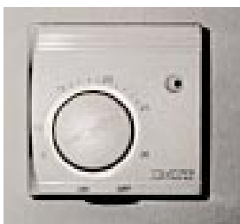
Χειροκίνητος θερμοστάτης χώρου.
