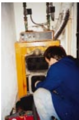
Μία εγκατάσταση που λειτουργεί με βαθμό απόδοσης 78%, μπορεί, μετά τη συντήρηση και την κατάλληλη ρύθμιση, να φτάσει σε μια απόδοση 88,5% μειώνοντας έτσι την κατανάλωση καυσίμου κατά 12%.
